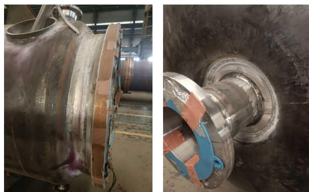
图 12 E1、E2 焊缝外观
